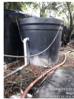
Fotografía No. 6 Tanque de Floculación
